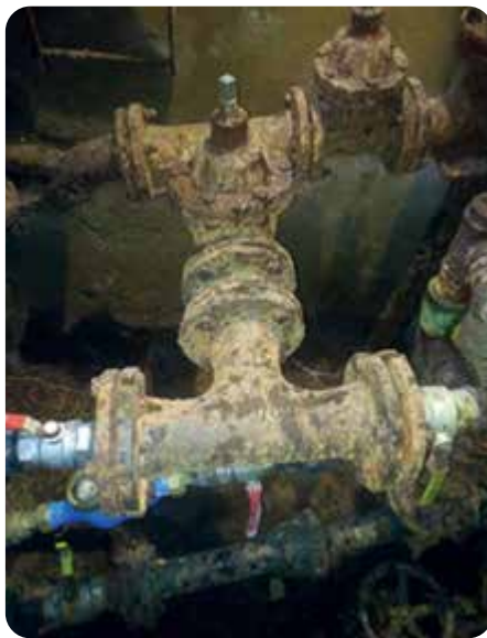
Původní armaturní sestava v rekonstruovaném vodojemu.
