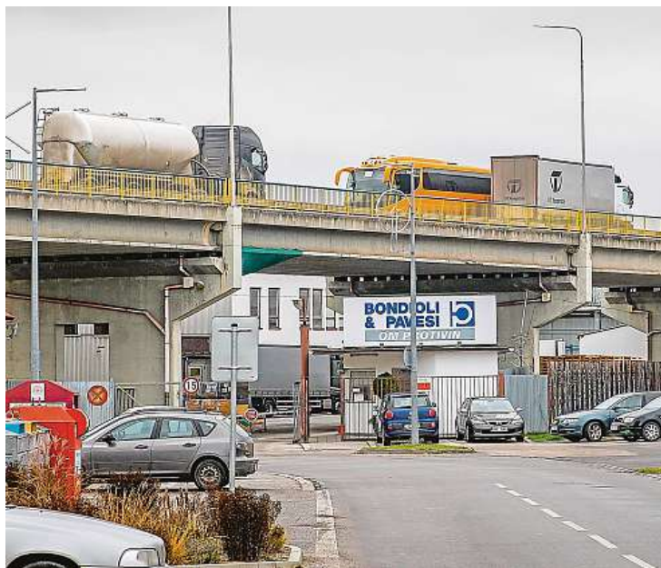
Současný 350 metrů dlouhý most na okraji Protivína je poškozený tak, že bude nutné ho zbourat a postavit nový. FOTO | PETR LUNDÁK, MAFRA
