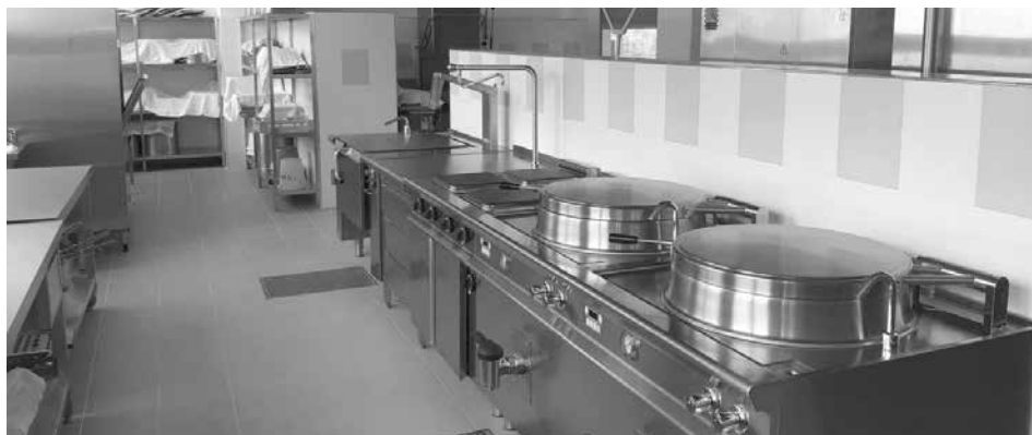
Nové vybavení kuchyně na ZŠ Smetanova.
