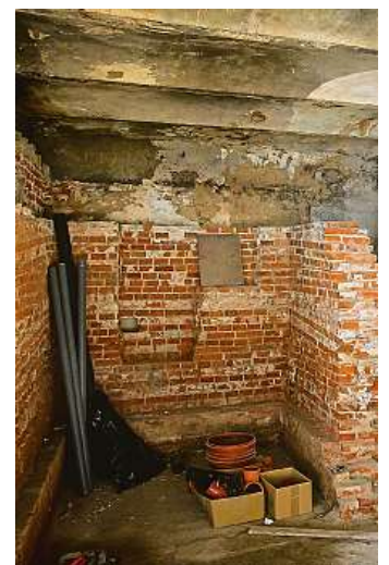
Vnitřek budovy potřebuje kompletní rekonstrukci.
