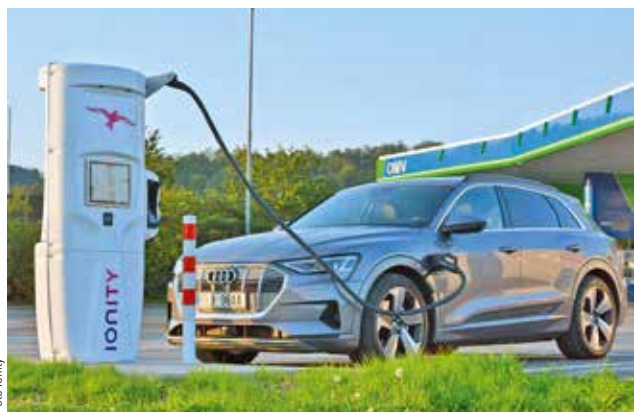
SUPERVÝKON. Nabíjecí stanice pro elektromobily na čerpací stanici v Berouně nabídne výkon až 350 kilowattů.
