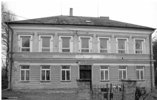
Škola mezi Boubskou a Bořanovicemi sloužila dětem z obou osad, dnes je opuštěná a chátrá.
