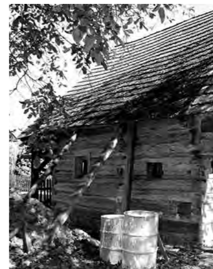
TORZO OBJEKTU BYLO NĚKOLIK LET PROVIZORNĚ ZAJIŠTĚNÉ.
