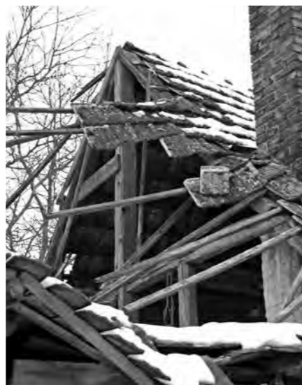
NA PODZIM ROKU 2008 SE JIŽNÍ ČÁST ZCHÁTRALÉHO DOMU ZŘÍTLA.
